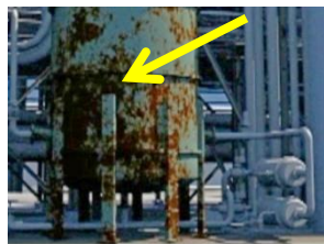
タンクが発錆し、腐食している
