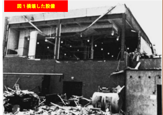
図1 破壊した設備
