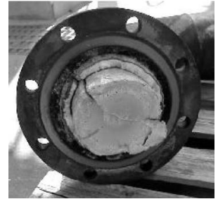
図1 閉塞したベント配管
