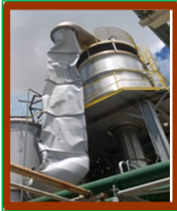
図1 真空で潰れた乾燥機の入口ダクト
