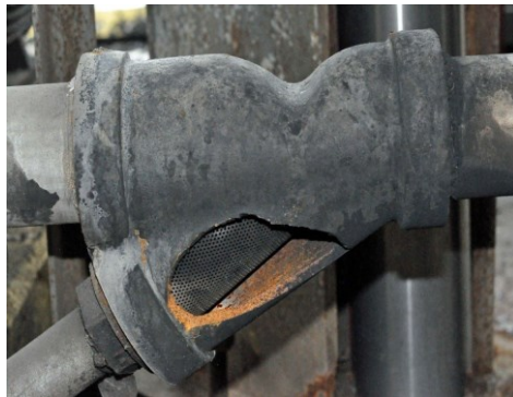
図2. 当該ストレーナーの破孔。過大な圧力により脆性破壊を起こした。
