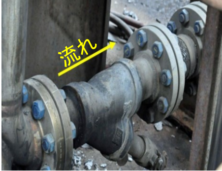
図1. 溶接ステンレス鋼の配管に鋳鉄のY型ストレーナーが誤って組み込まれていた。
